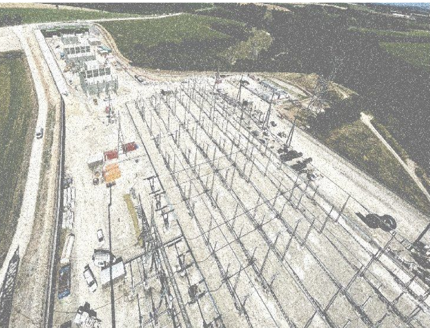
Photo : Transformateur électrique de Saint-Victor-et-Melvieu (12)
