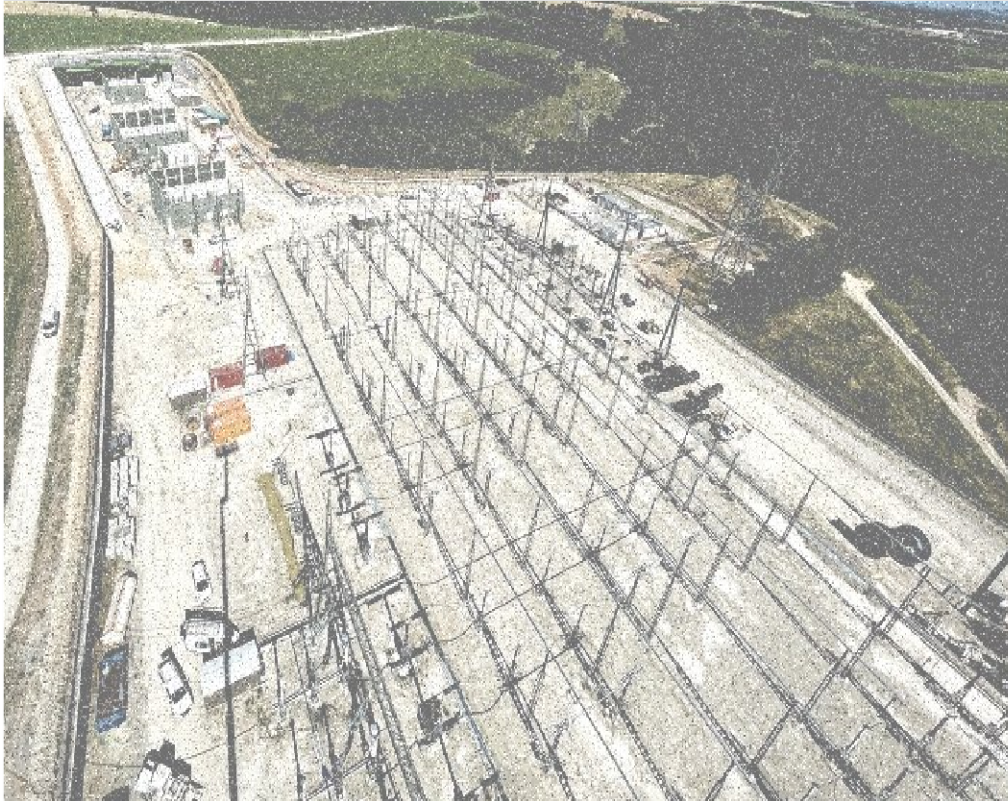
Photo : Transformateur électrique de Saint-Victor-et-Melvieu (12)
